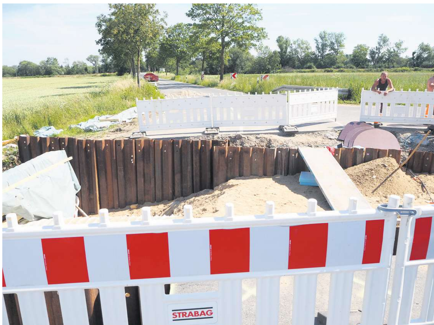
Noch kein Ende in Sicht: Die Mitarbeiter der Baufirma sind „noch lange nicht“ fertig mit dem Grabendurchlass.
