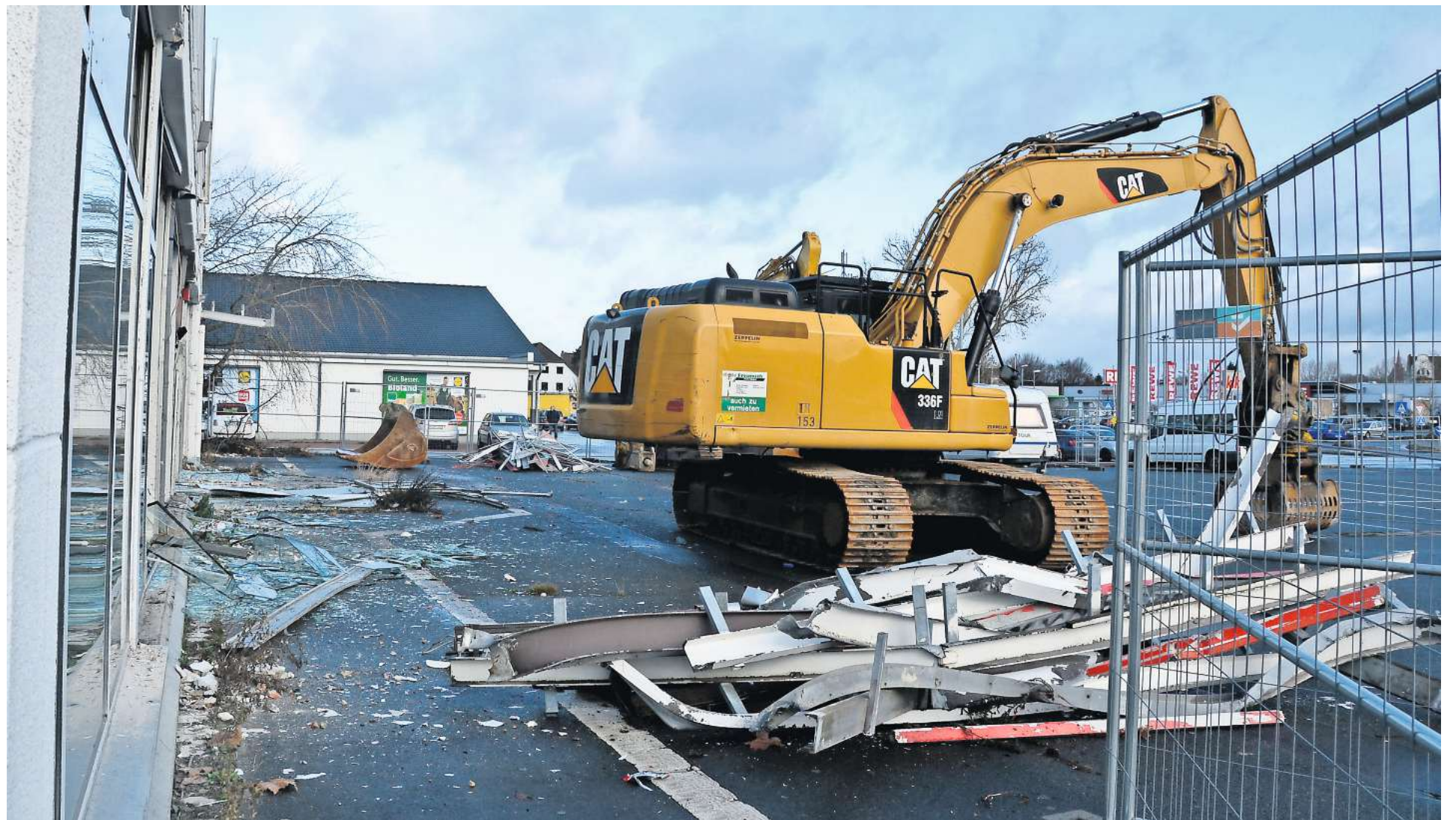
Erste Fassadenteile wurden bereits abgerissen. Der Bagger steht bereit, um auch den Rest des Extra-Marktes zu entfernen.
